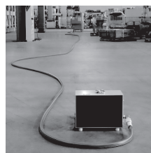
コンプレッサ(画像奥)と エア供給BOX
