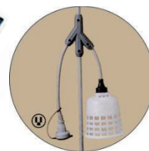
・立ち上げ照明 (縦引き分岐ケーブル)
